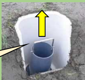
水位調節型落水口
