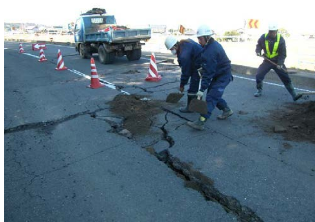
大洗友部線(大洗町成田町) 砕石敷均しによる道路亀裂箇所の応急対策
