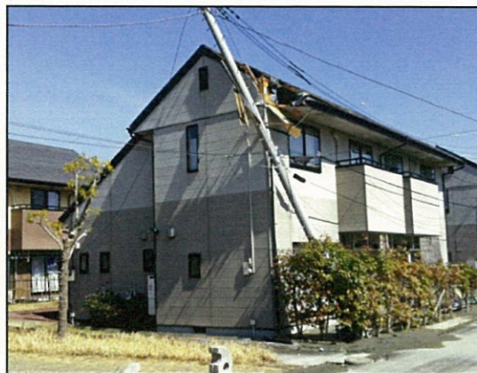
傾斜した電柱による被害
