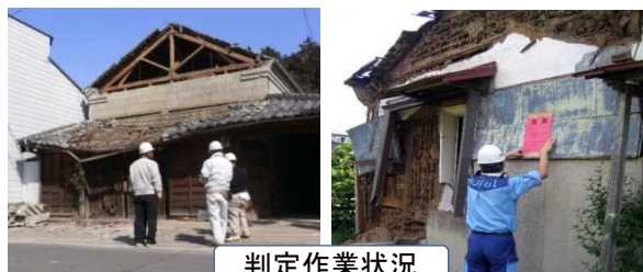
判定作業状況
