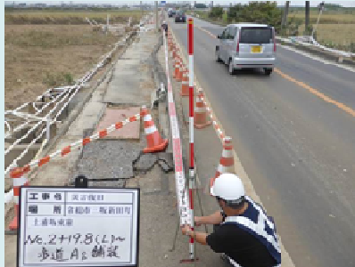
被災状況の調査 【(公社)茨城県測量設計コンサルタント業協会】
