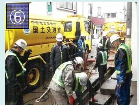
⑥ 浸水による泥の清掃作業 【国土交通省・(一社)茨城県建設業協会】
