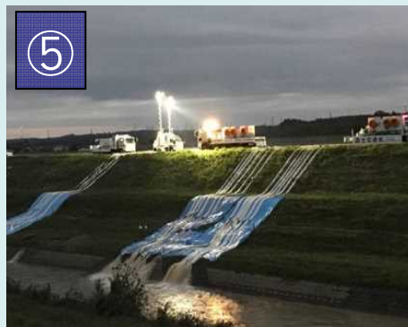
⑤ 西田川(水戸市)の排水作業 【TEC-FORCE(緊急災害対策派遣隊)】
