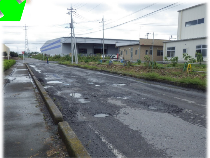
<写真 ひび割れによる破損の進行例>
