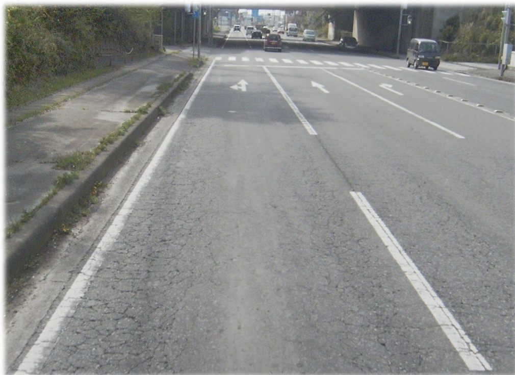
<写真 茨城県内の一般国道のひび割れ発生状況>
