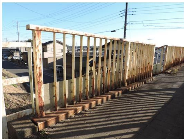
健全性Ⅱ：経年劣化による腐食 (高浜歩道橋、石岡田伏土浦線、1968年架設)
