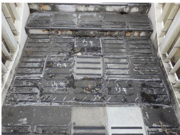
健全性Ⅱ：タイル舗装のうき (東海歩道橋、常陸那珂港山方線、1968年架設)
