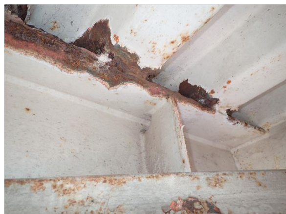
健全性Ⅱ：漏水による腐食 (下高津歩道橋、国道354号、1972年架設)
