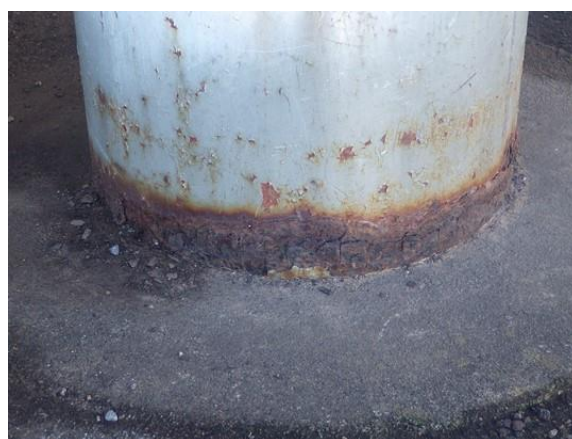
健全性Ⅱ：橋脚付け根の腐食 (取手歩道橋、国道294号、1969年架設)
