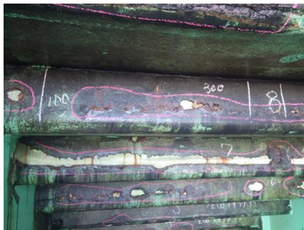
健全性Ⅲ：孔食が連続した著しい腐食 (明神前歩道橋、国道124号、1971年架設)
