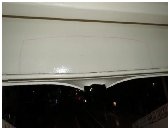
健全性Ⅱ：衝突による変形 (橋本歩道橋、国道354号、1970年架設)
