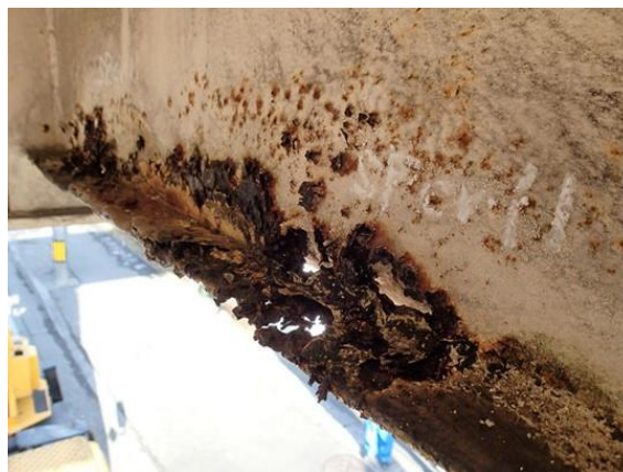
健全性Ⅲ：床版からの漏水による腐食 (文京2丁目歩道橋、国道118号、1981年架設)
