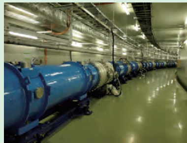
J-PARC ニュートリノ陽子ビーム輸送ラインの超伝導電磁石 画像提供:J-PARCセンター
