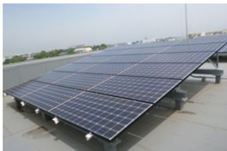
「サイクルステーションとりで」機械式駐輪機の格納庫上に設置された太陽光パネル 出典：取手市HP
