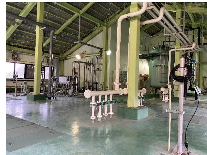
エコフロンティアかさま浸出水処理施設内部 右奥が砂ろ過タンク
