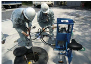
地下軽油タンク燃料抜き取り訓練
