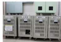
中央制御室計器用 予備電源
