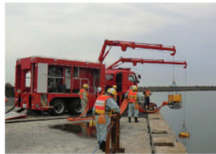
大容量送水システムポンプ設置
