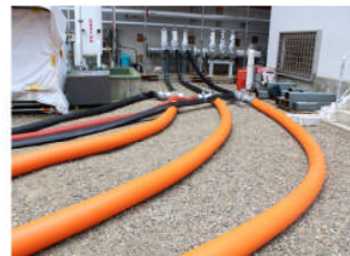
大容量送水システム通水状態
