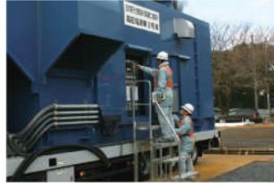
高圧電源車運転確認
