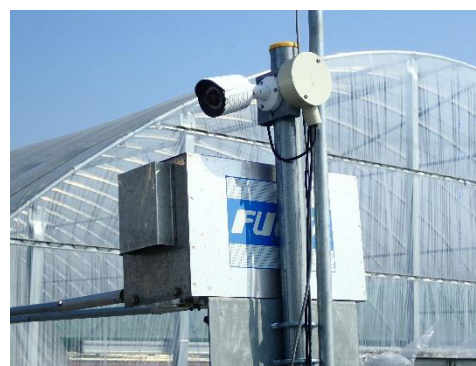
防犯カメラの設置
