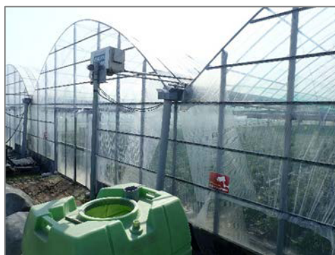
防犯カメラの設置
