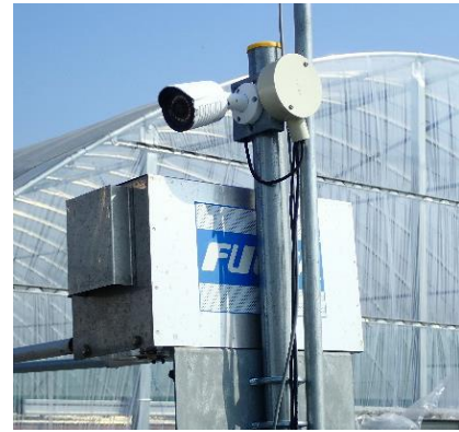
防犯カメラの設置
