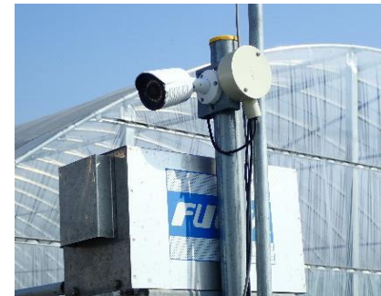
防犯カメラの設置
