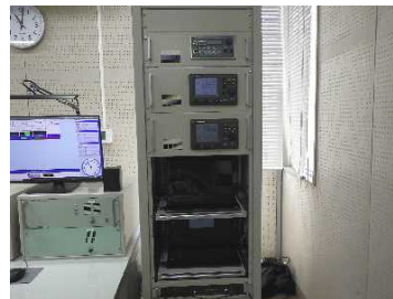
③ データ通信用設備
