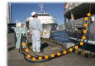
電力供給設備
