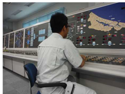
浄水場の運転監視業務
