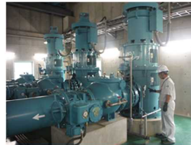
機械電気設備の点検業務
