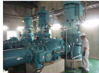
機械電気設備の点検業務
