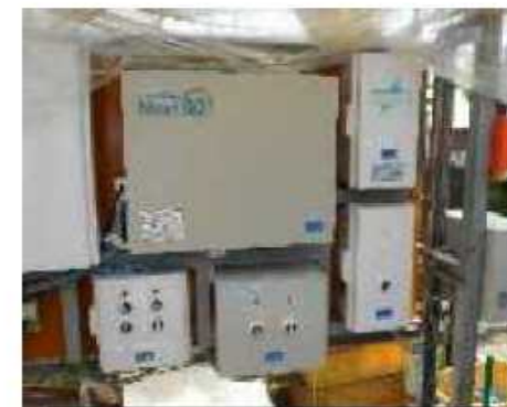
環境制御システム
