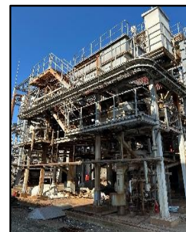
焼却炉(対策前)
