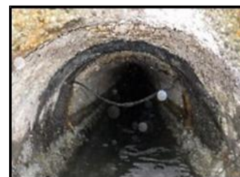
下水道管(対策前)
