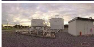
給油施設（燃料タンク2基）
