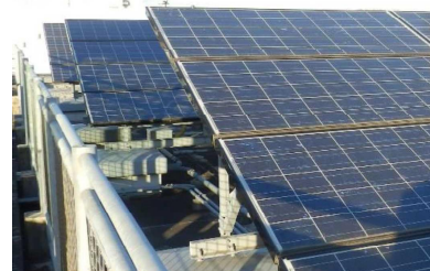
百里空港事務所屋上に設置した太陽光パネル
