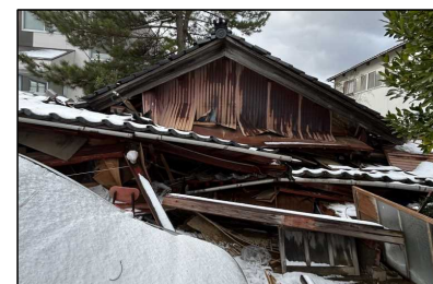
地震による木造住宅の被害
