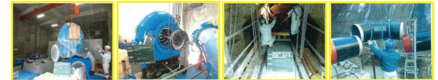
施工中の様子(左から、水車搬入、ランナ取付、利水放流バルブ移設、水圧鉄管取付)
