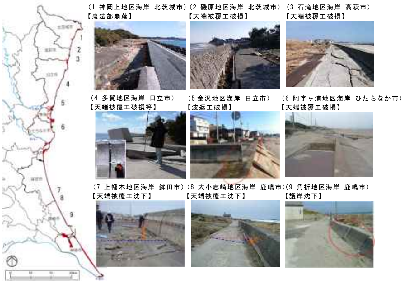
写真 2.3 東日本大震災における海岸保全施設の主な被災状況
