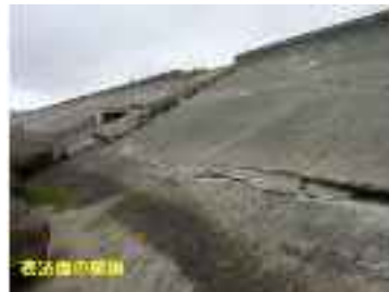
■表面の破損 (神岡上地区海岸 北茨城市)
