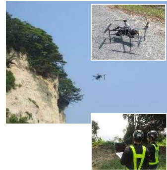
■ドローンによる崖海岸侵食調査 （五浦地区海岸 北茨城市）
