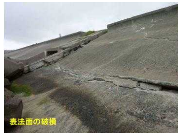
■表法面の破損 (神岡上地区海岸 北茨城市)
