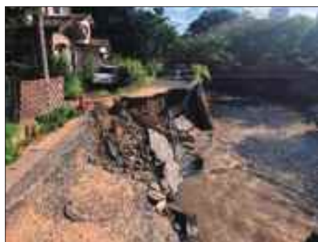
管渠の被災状況 (日立市：神峰町)
