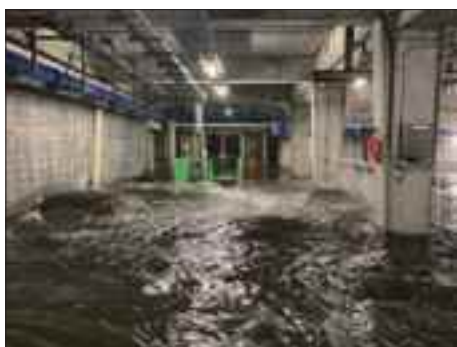
処理場の浸水状況 (日立市：池の川処理場)
