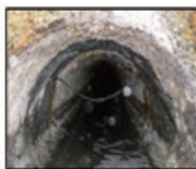
老朽化した下水道管
