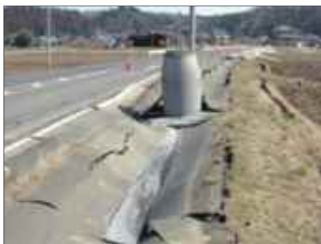
液状化によるマンホールの隆起 (常陸太田市)
