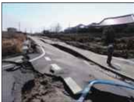
液状化による道路のうねり (鹿嶋市)
