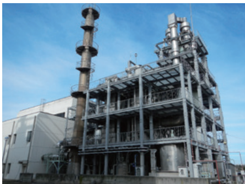
広域汚泥 1号焼却炉
