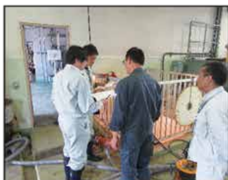
被災後のし尿処理施設の状況 (大子町・衛生センター)
