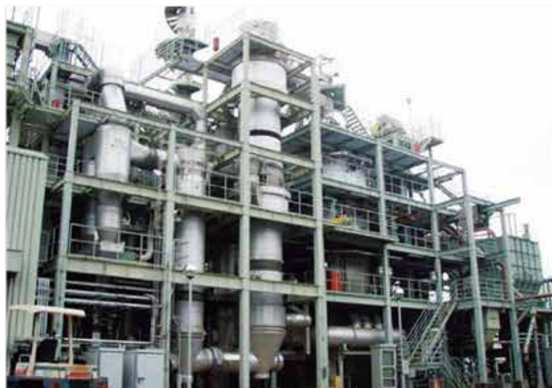
広域汚泥 1号焼却炉
