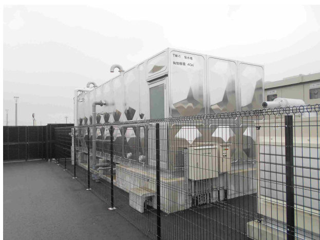
(耐震性貯水槽)
