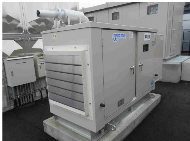
(非常用発電装置)
