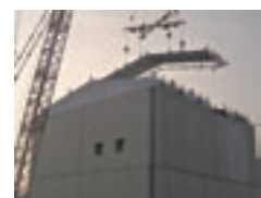
1号機原子炉建屋カバー屋根パネルの設置作業(2011年10月14日東京電力撮影)
